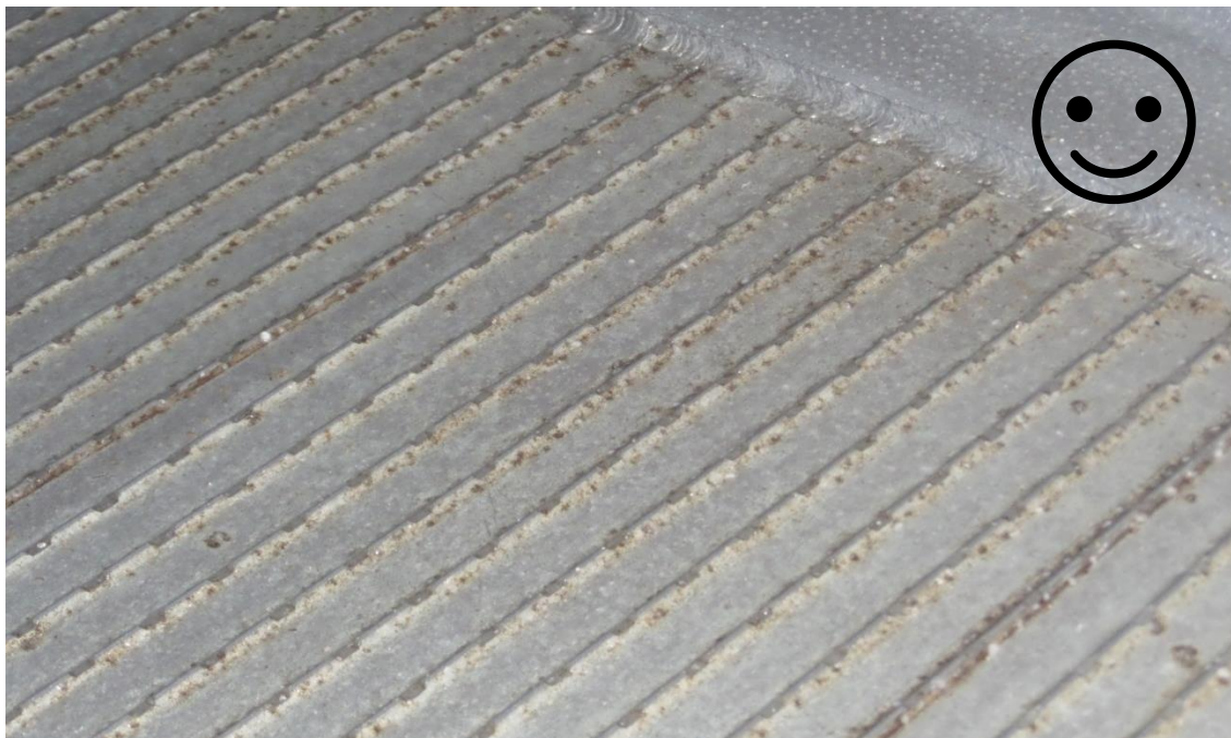
Figur 8. Rustnister – OK/Rust flecks – OK.
