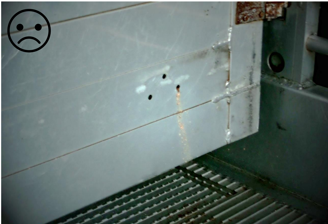
Figur 17. Skillevæg med huller – AFVIST. Der er tydeligvis skidt inde i skillevæggen. Partition wall with holes – REJECTED. There is clearly dirt in the partition wall.
