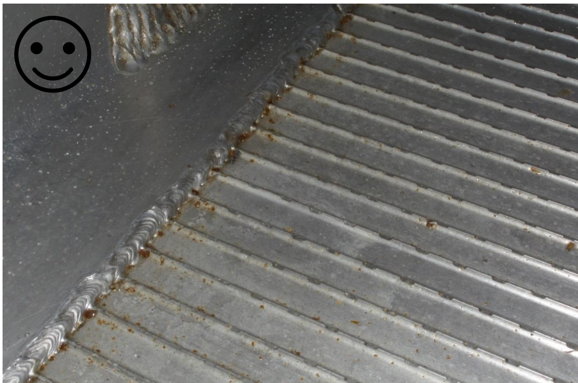
Figur 9. Rustnister – OK / Rust flecks – OK.
